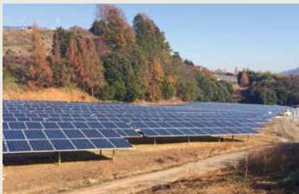
納入実績：京都伏見桃山 9.9MW
