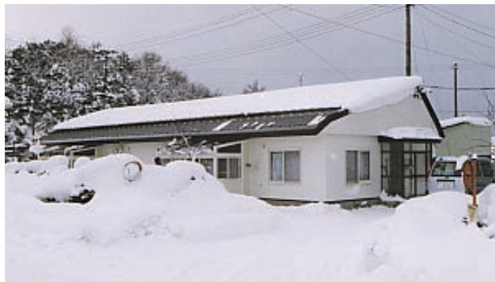
屋根融雪 (ルーフヒーティング)
